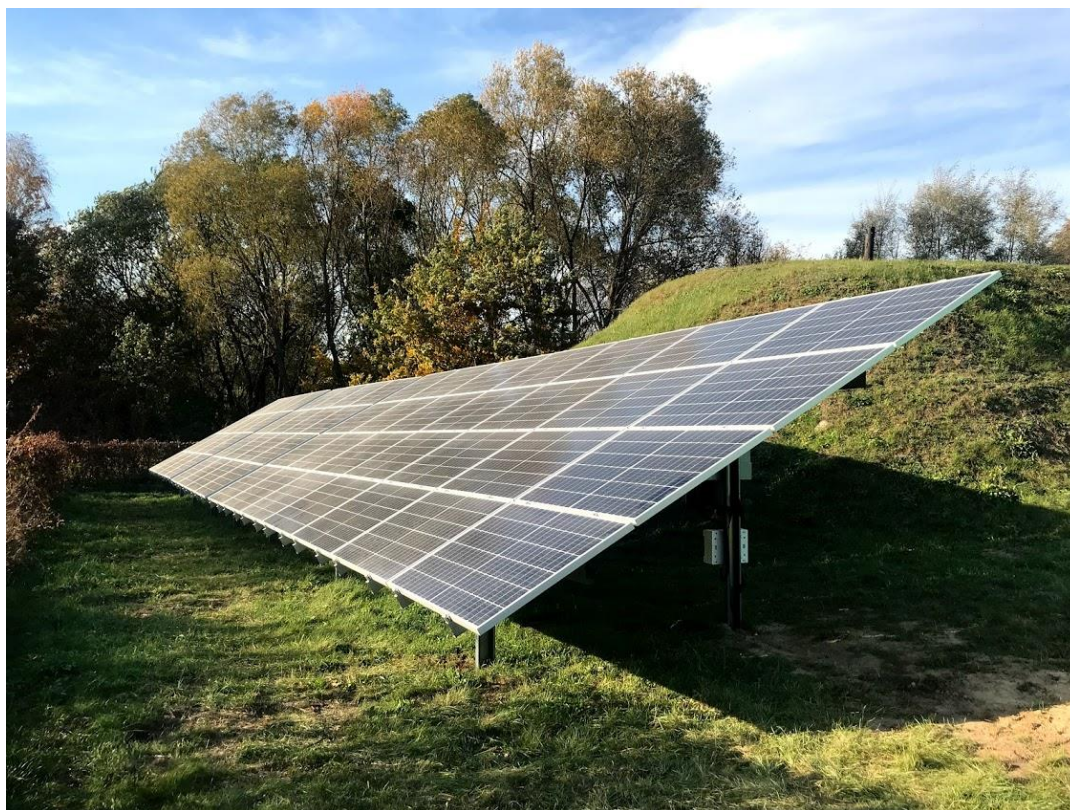
Fot. Instalacja fotowoltaiczna na terenie oczyszczalni ścieków w Nowym Dzikowcu.
